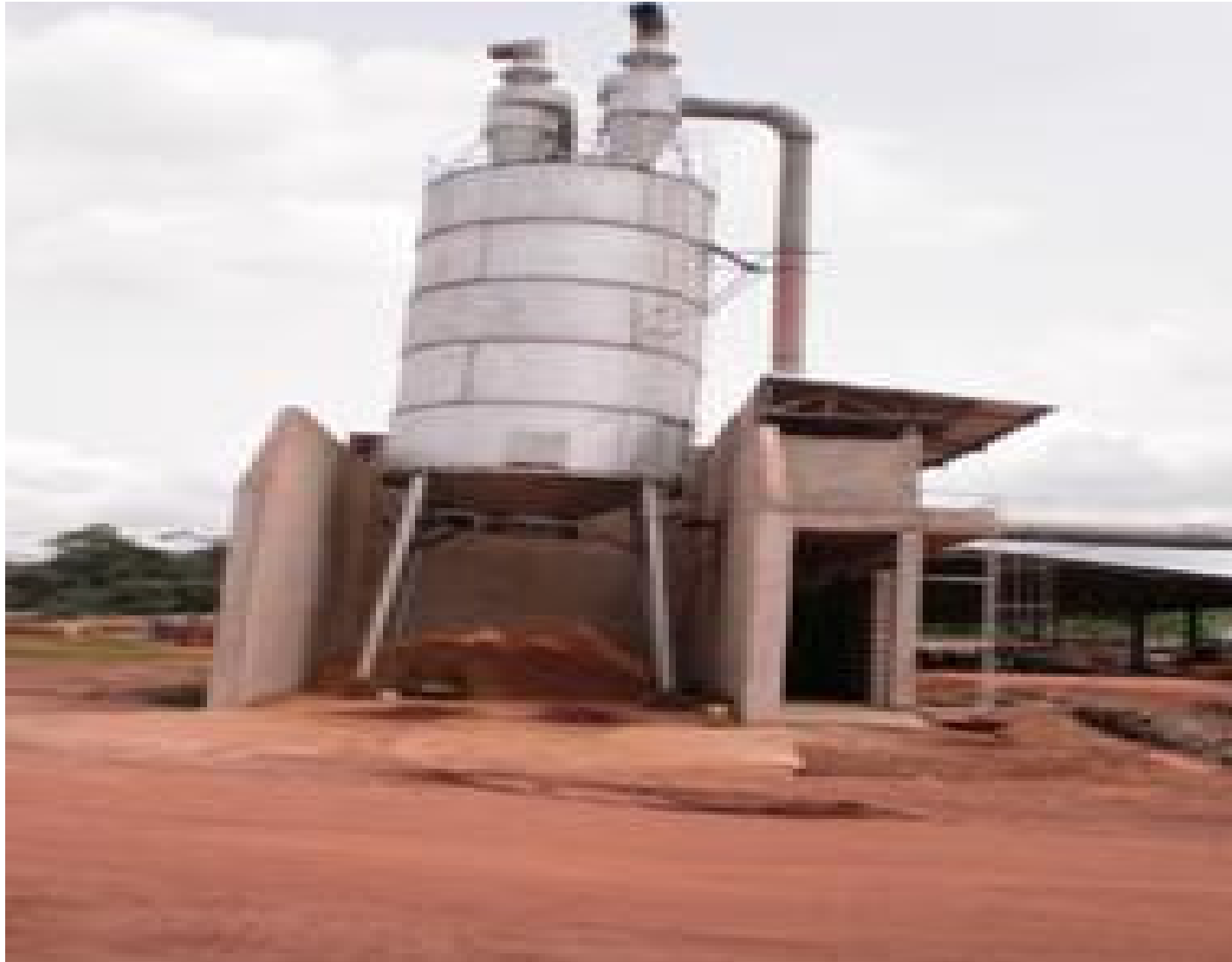
photo 4 : vue de face du silo collecteur dont le rôle est de collecter et conserver la sciure
