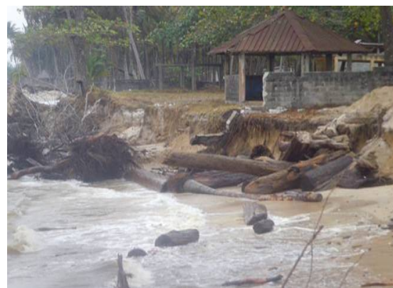
Conséquences des extractions de sables, occasionnant des dommages considérables sur les aménagements littoraux (Sablière). Photo Boussougou I., 2007.
