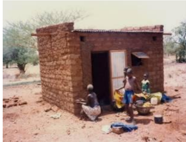
Photo 3 : bâtiment en banco de 8 tôles en cours de crépissage par les bénéficiaires (Photo Boureima NÉBIÉ)
